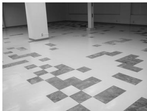
床タイルの剥がれ
